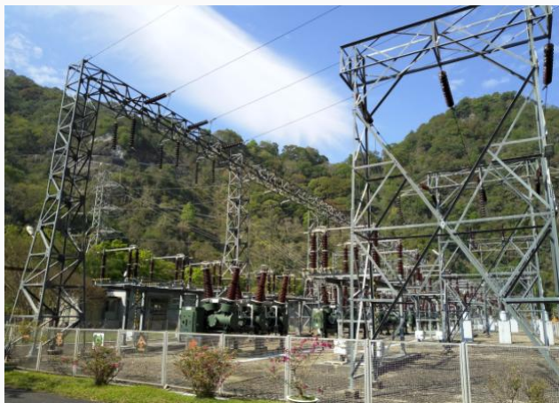
萬松水力發電廠-變電所
